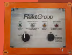
Pannelli di controllo
