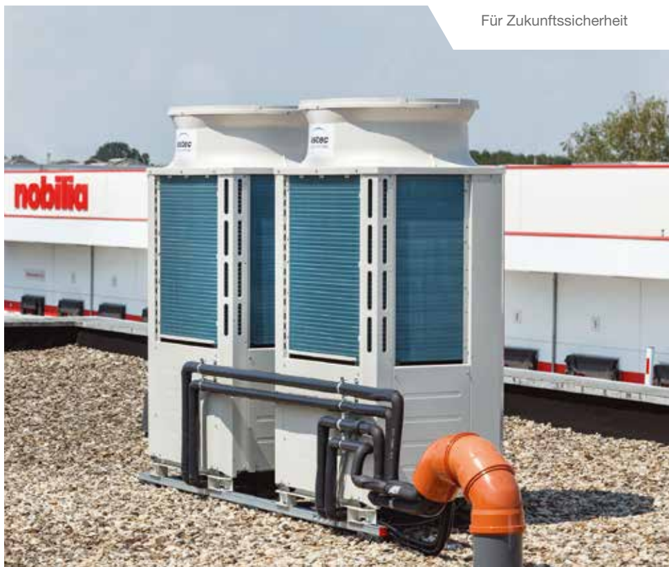
Das Flachdach des Bürogebäudes eignet sich optimal für den Aufbau der Außengeräte. Von hier aus versorgen die City Multi VRF-Einheiten die beiden Stockwerke mit genügend Kälte- und Heizleistung.
